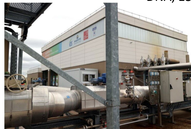
La centrale géothermique de Rittershoffen est toujours à l'arrêt. Photo Laurent Réa
